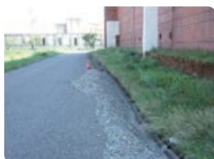
地盤の沈下による被害
