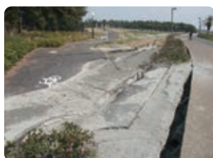
地盤の流動破壊
