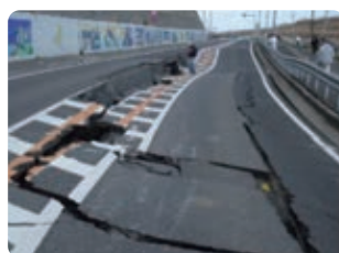
道路盛土のすべり破壊
