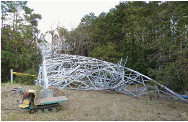
【図7】強風により倒壊した送電鉄塔
