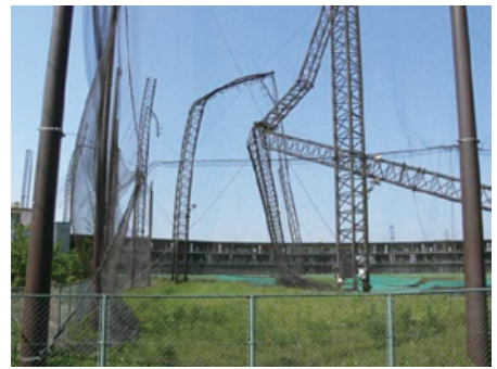
【図5】ゴルフ練習場のネット支柱の倒壊 1)
