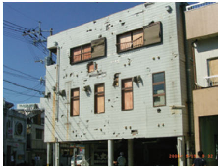
【図4】竜巻により生じた飛散物による被害 1)
