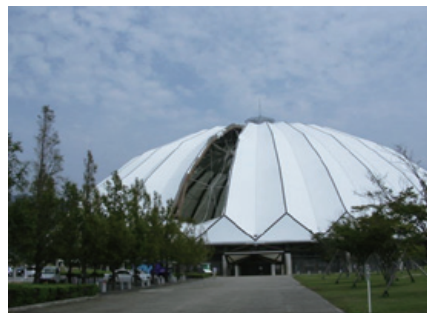
【図3】木造ドームの膜屋根の被害 1)
