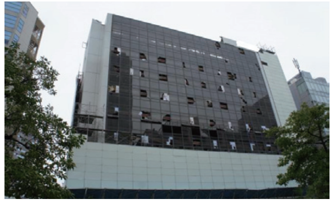
【図8】足場が倒壊した解体中の建物（外壁が見える部分の足場が倒壊した） 1)
