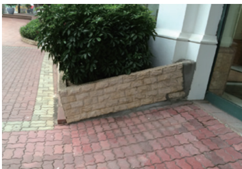
【図4】ビル周辺地盤が圧密沈下を起こし、ビルと段差ができています
